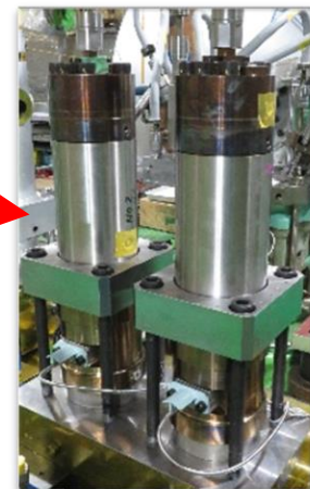
アンモニア 注入ポンプ
