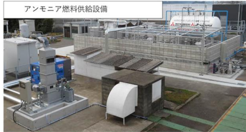
アンモニア供給設備
